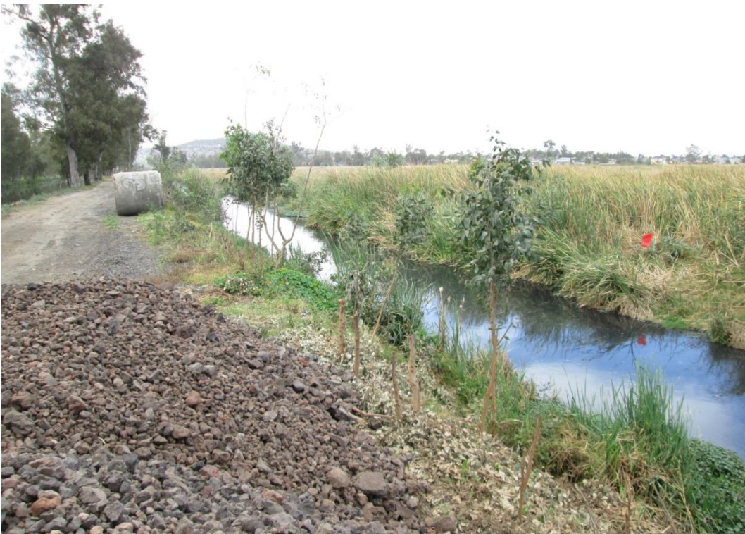
Imagen 41. Condiciones del vaso antes de realizar el desazolve
