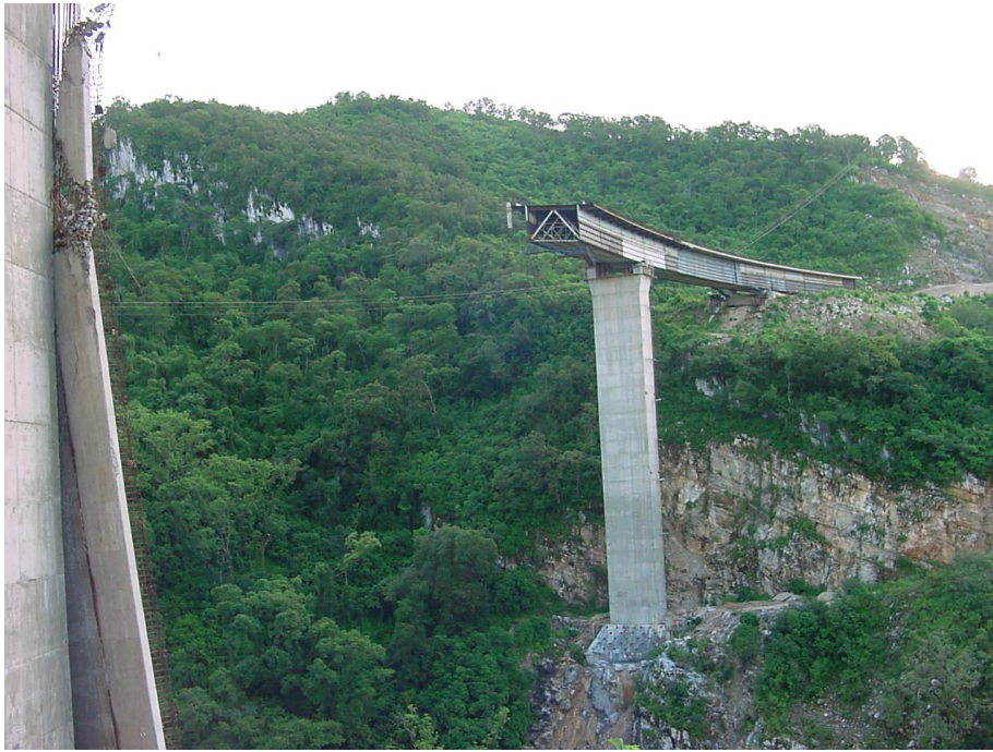
A LA IZQUIERDA, LA PILA DAÑADA A LO LEJOS, EL LADO SAN CRISTÓBAL DEL PUENTE
