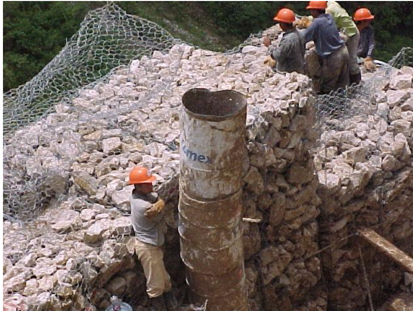
GAVIONES COLOCADOS EN LA BASE DE LA PILA PARA LA PROTECCIÓN DEL TALUD
