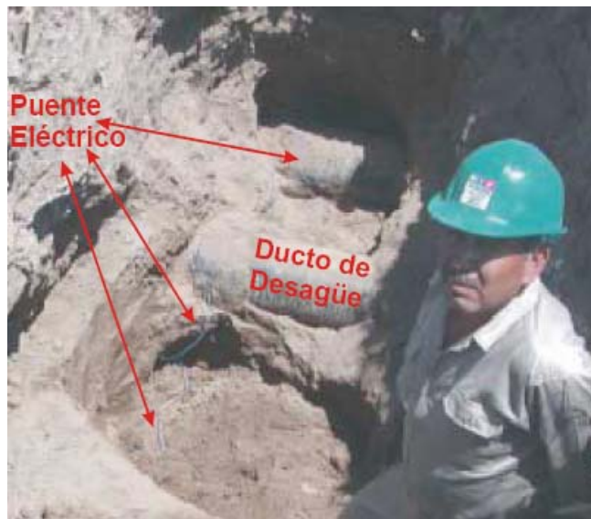
Fig. 6.11. Excavación realizada en el bordo sur del canal que confirma con exactitud de 20cm, la posición del puente eléctrico detectado con la tecnología desarrollada.
