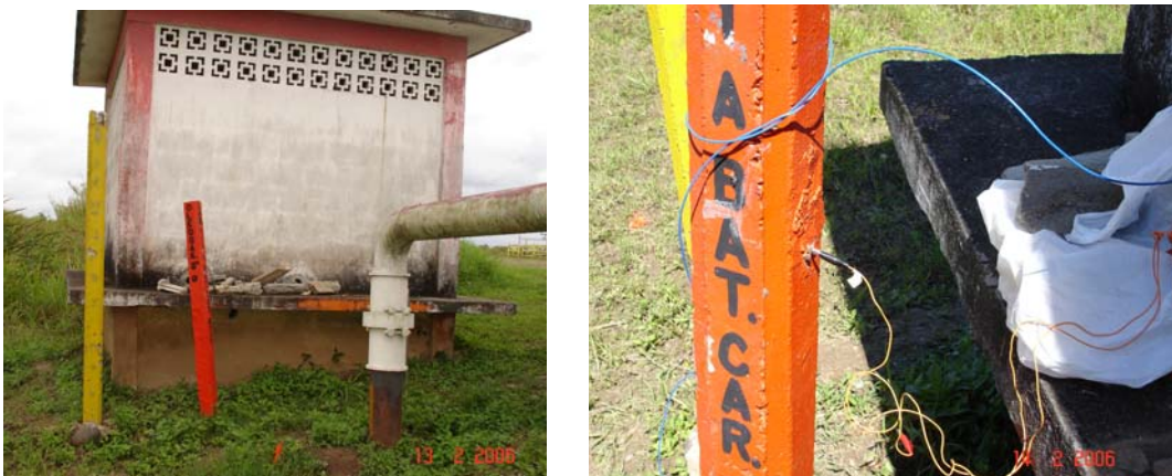
Figura 5.1 A) Poste de control típico (en color naranja) ubicado sobre un ducto B) Conexión de una Terminal del generador externo al poste de control de protección catódica.
