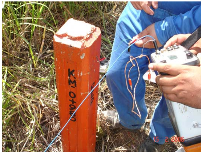
Figura 5.3 Medición de los voltajes en los postes de control de protección catódica.
