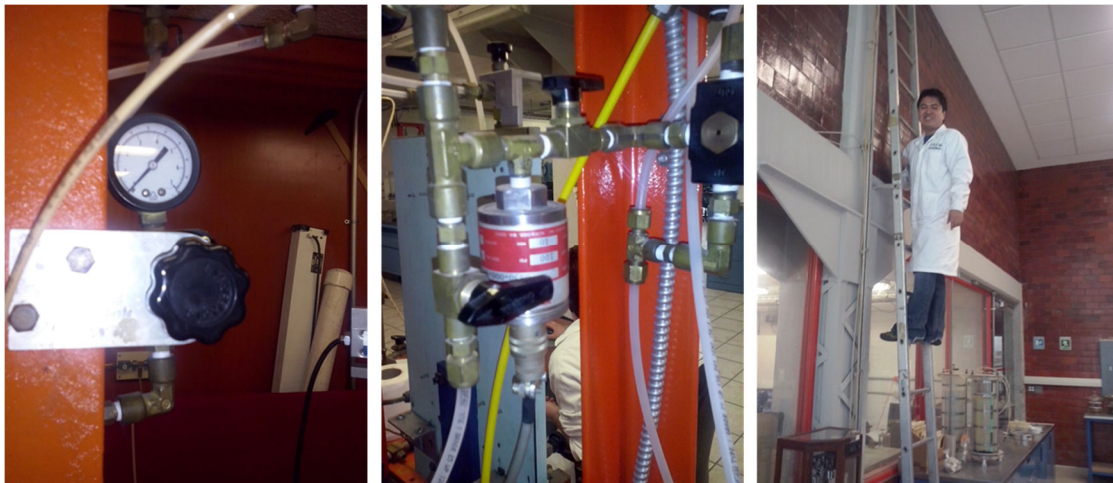
Figura 2. 11 Calibración de presión.
