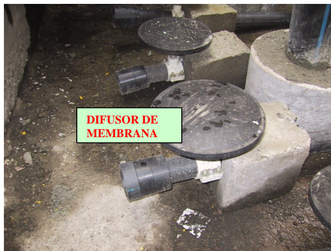
Figura 4.19 Tubería de polietileno con sus difusores
