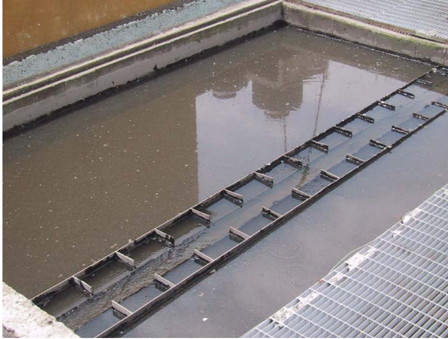
Figura 4.4 Vista del sedimentador secundario mostrando el desnatador propuesto ya instalado
