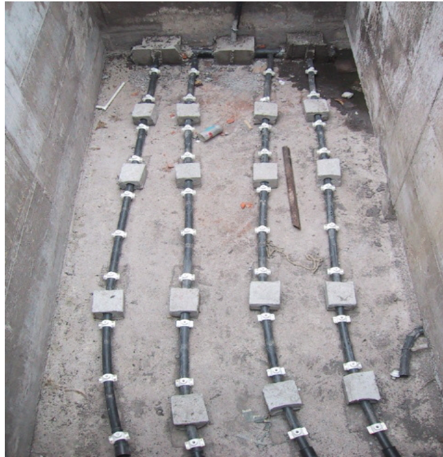
Figura 4.18 Tubería de polietileno con sus abrazaderas para colocar los difusores
