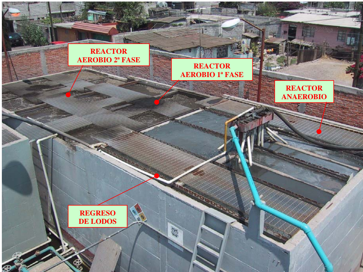
Figura 4.6 Tubería de regreso de lodos (color blanco).
