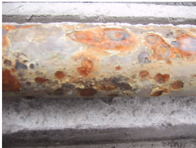
Figura 4.16 Tubería acero oxidada por la generación de ácidos en los lodos de las aguas
