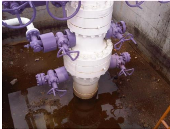
Figura 62 Cabezales en superficie antes de tratamiento.
