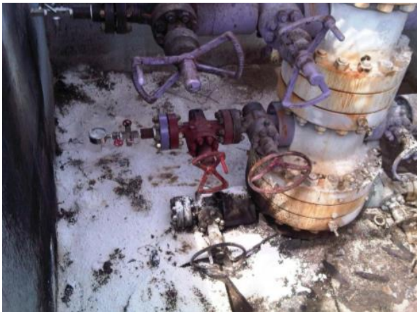
Figura 64 Cabezales hundidos por contracción térmica.
