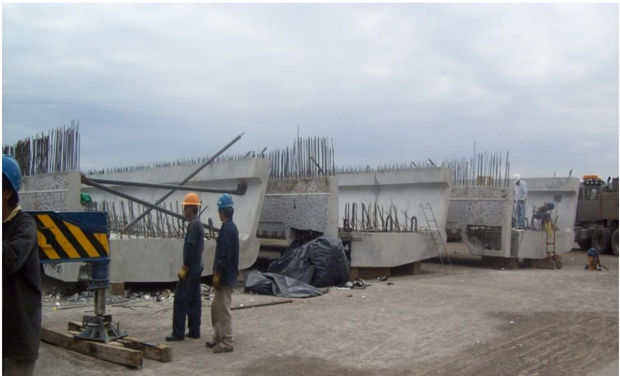
Figura IV.3.17.- Almacenaje para su detallado. (Foto tomada por el autor)
