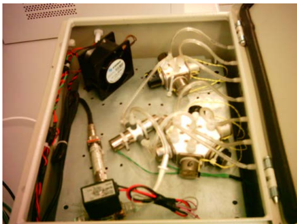
Figura 2.3 Conexiones dentro del gabinete
