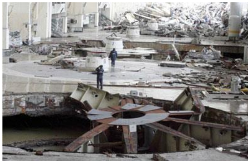
Figura 2. Fotografía de la falla de grupos turbogeneradores en la central Sayano-Shushenskaya, Siberia (Ray, 2010)
