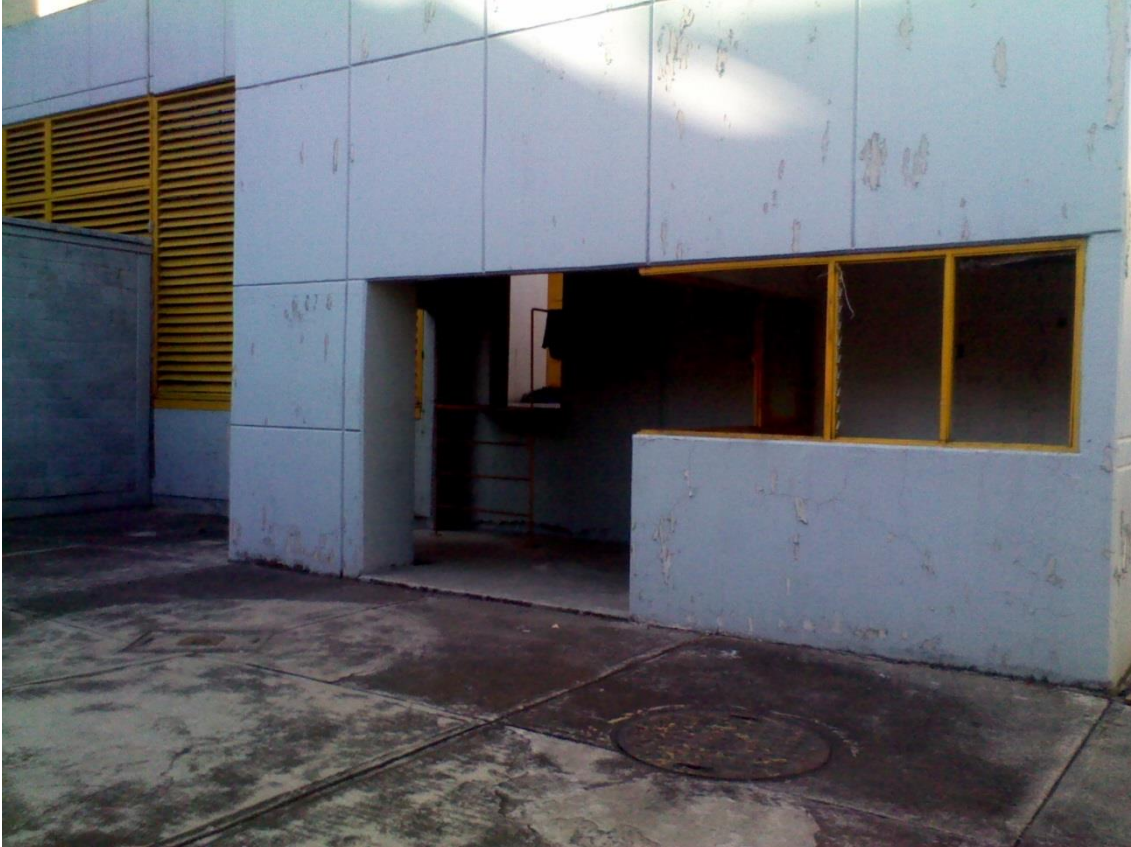
Figura 4-4 Entrada a la Subestación de rectificación.
