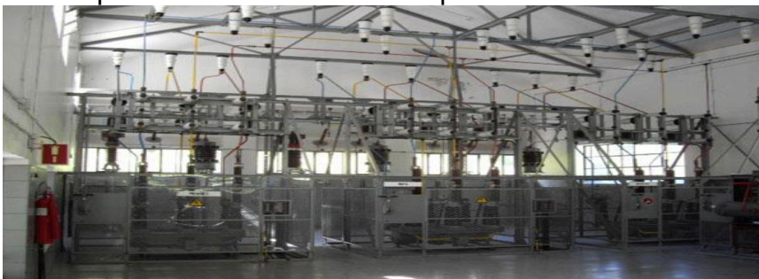
Figura 2-8 Subestación tipo interior.
