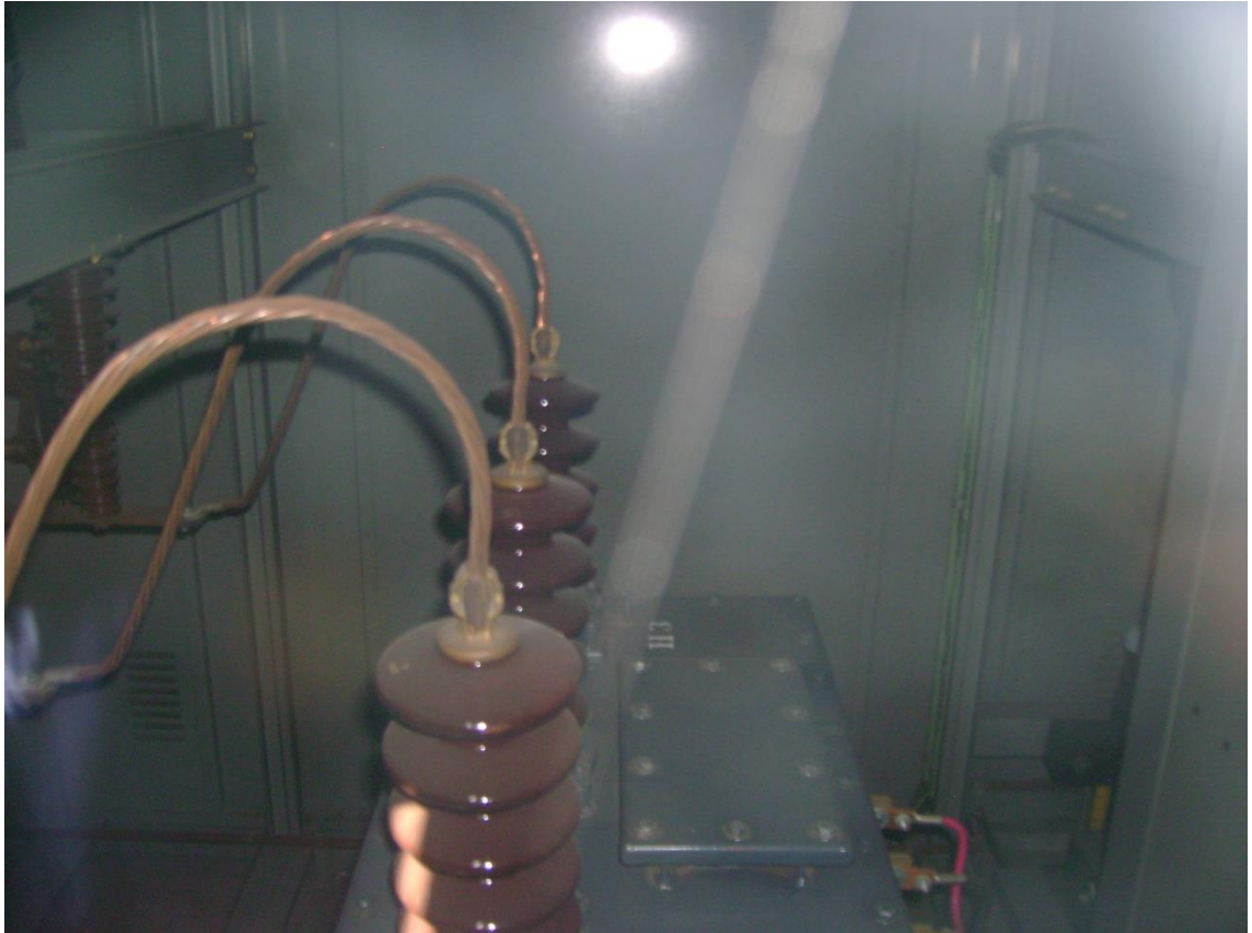
Figura 4-12 Transformador auxiliar (TX)
