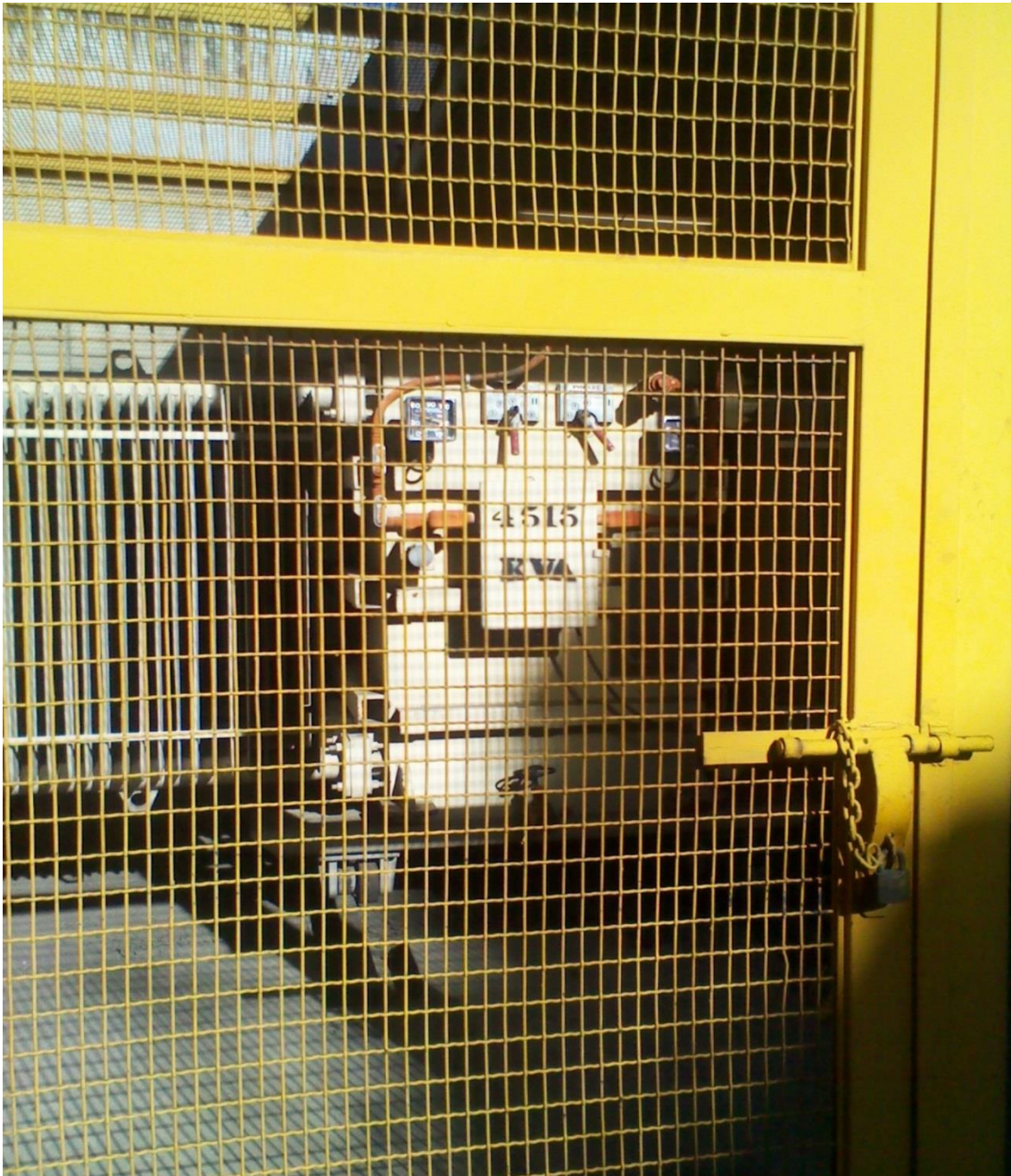
Figura 4-15 Transformador de potencia.
