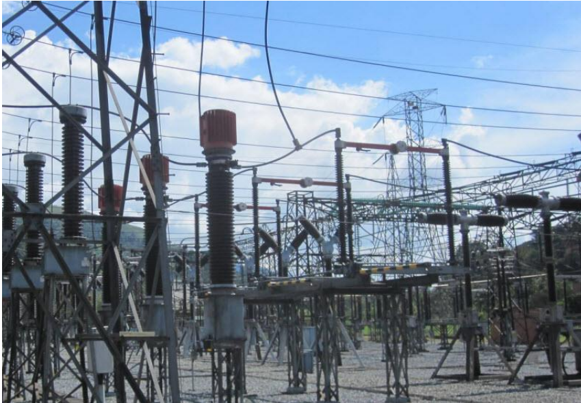
Figura 2-3 Subestación Eléctrica de Alta Tensión.
