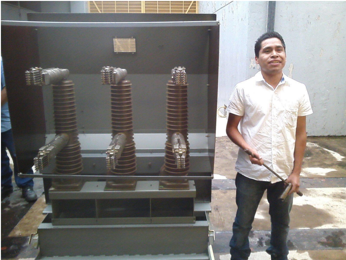
Figura 4-13 Disyuntor de mediana tensión en hexafluoruro de azufre.
