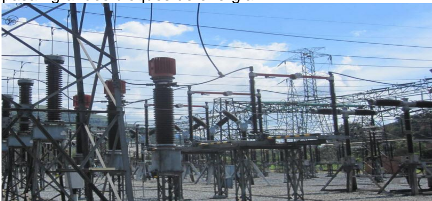
Figura 2-4 Subestación eléctrica de Texcoco.
