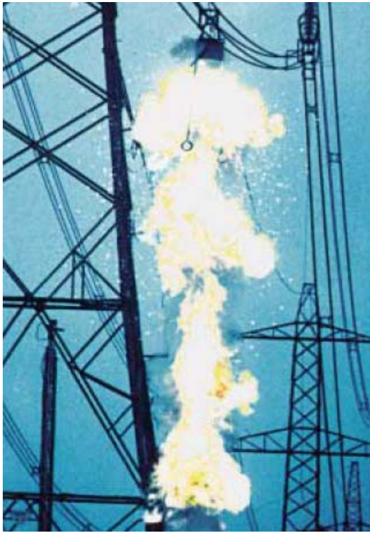
Figura 1.7 Comienzo de una Falla en una línea aérea
