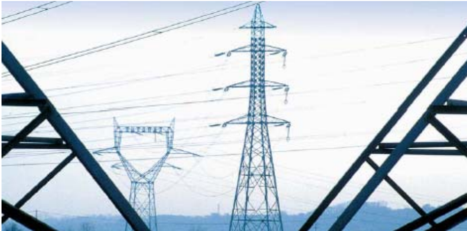
Figura 1.18 Líneas de Transmisión
