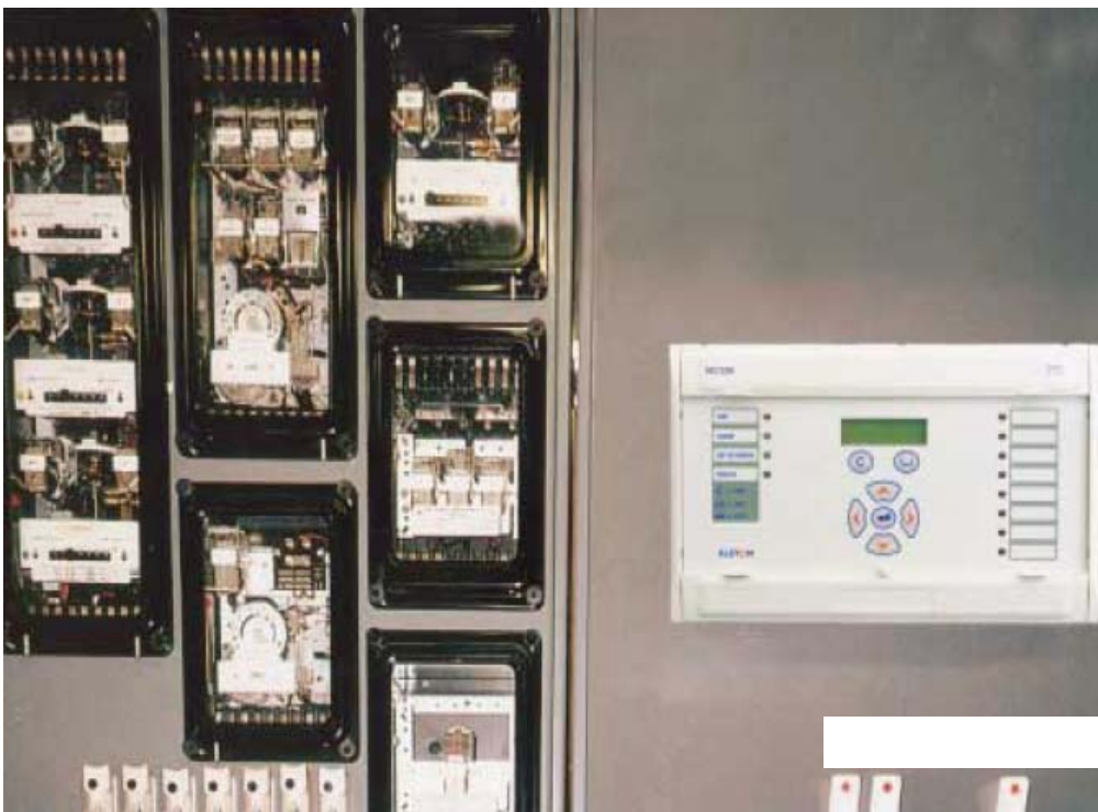
Figura 2.9 Espacio requerido para diferentes tecnologías de relevadores y misma Funcionalidad. Izquierda: Relevadores electromecánicos. Derecha: Relevador numérico
