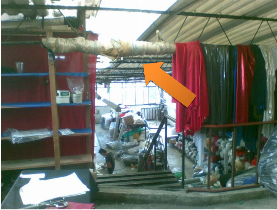
Imagen 17 Barra a la altura de la cabeza no señalizada.
