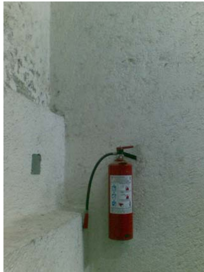
Imagen 23 Extintor sin señalizar en el edificio de corte
