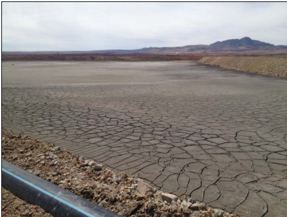
Figura 10. Presa de jales “Los Chinos” con falta de recubrimiento
