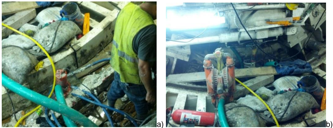
Fig 2.42 Filtraciones durante la excavación: a) distribución de costales de arena en la parte inferior del anillo; b) uso de bomba de achique para retirar el agua hacia el contenedor de agua residual de la máquina (Prácticas profesionales del Colegio de Ingenieros Civiles de México –CICM–; Reyes, 2013).
