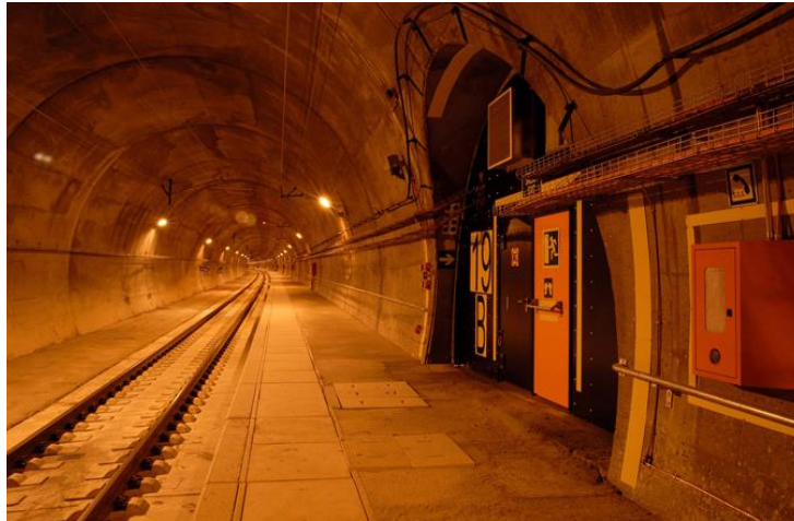
Fig 2.8 Instalación eléctrica del túnel en el Oeste de San Pedro (Línea de Alta Velocidad (LAV) Madrid-Valladolid) (fuente: Grupo OHL, 2012).
