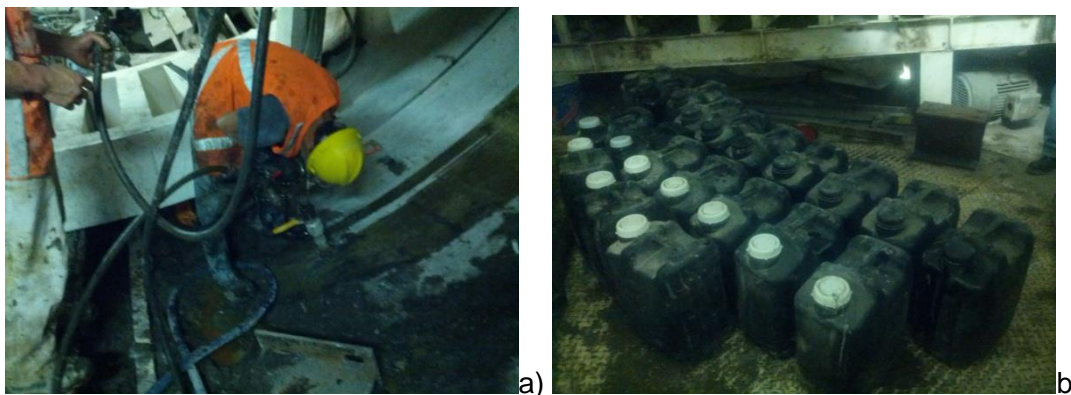
Fig 2.45 Segundo método: a) Inyección de resina en las dovelas de la parte inferior del anillo; b) Catalizador-Resina junto con la espuma de Poliuretano Poly-Tuff (Prácticas profesionales del Colegio de Ingenieros Civiles de México –CICM–; Reyes, 2013).
