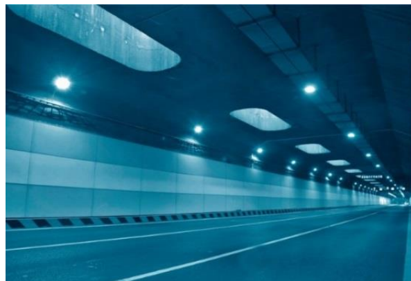
Fig 2.10 Túnel de carretera. Circunvalación oeste de Zurich N4/N20 Knonauremant, (fuente: http:// www.Phoenixcontact.com ).
