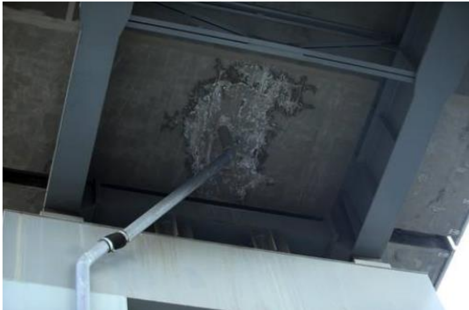
Fig 2.48 Filtraciones en traveses y columnas de concreto en la Línea 12 del metro inaugurada el 30 de octubre de 2012 (Fuente: http://www.jornada.unam.mx/2014/03/28/capital/039n1cap ).
