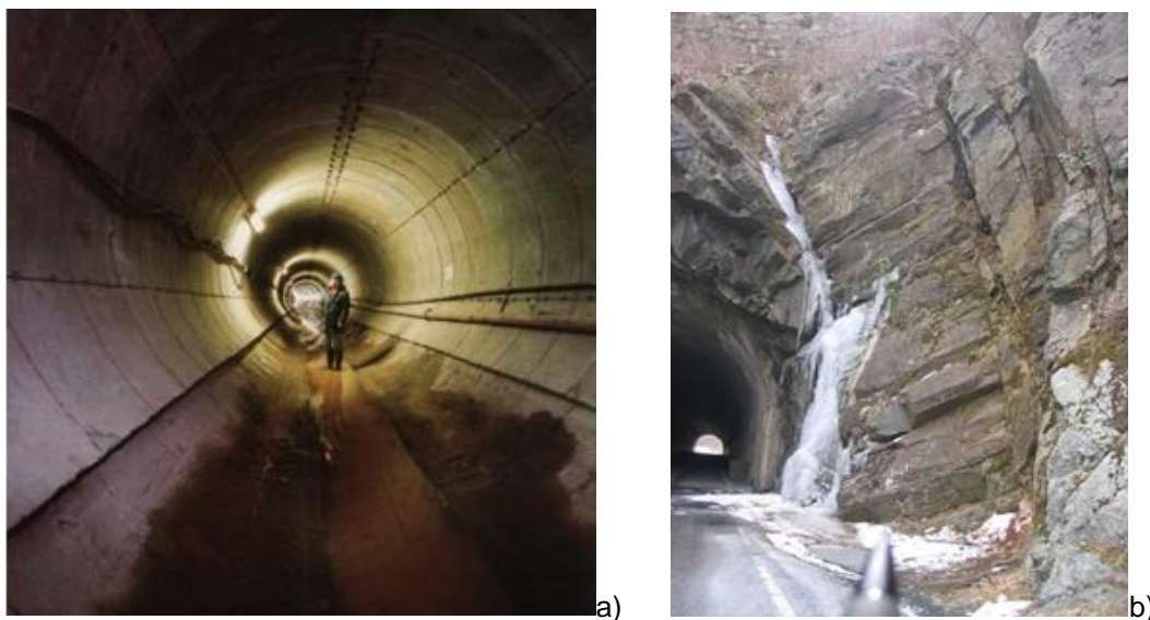
Fig 2.24 Ejemplo de filtraciones y flujo de agua: (a) filtraciones de agua en un túnel; (b) flujo de agua a través de un estrato de basalto permeable (fuente: http://tunnels.piarc.org/tunnels/ressources/4/542,Chap-5-Environmental-issues-v-11.10.pdf ).
