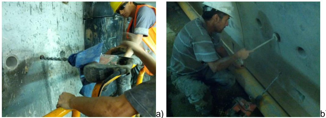
Fig 2.44 Segundo método: a) Realizar la perforación en zona del taco sofrazar de la dovela y b) Adaptación y colocación de válvula a dovelas para inyectar sustancia (Prácticas profesionales del Colegio de Ingenieros Civiles de México –CICM– ; Reyes, 2013)
