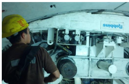
Fig 2.39 Túnel Emisor Oriente: a) Zona de la banda transportadora de material de excavación; b) Maniobra y colocación de una dovela para un anillo del túnel (Prácticas profesionales del Colegio de Ingenieros Civiles de México –CICM–; Reyes, 2013).
