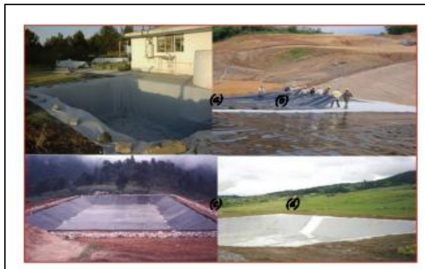
Figura 4.11 Cisternas revestidas con geomembrana y polietileno: (a) cisterna para uso doméstico, (b) transporte de geomembrana para recubrimiento, (c) cisterna sin tapa, (d) cisterna revestida y con cubierta flotante de geomembrana de PVC en San Felipe del Progreso, Edo de México (D. Phillips y col., 2006).
