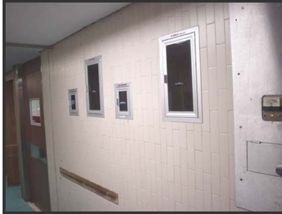
Figura 5.18: Ubicación del amperímetro en el pasillo de circulación.
