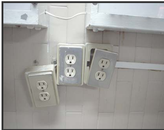
Figura 5.15: Vista frontal de los receptáculos
