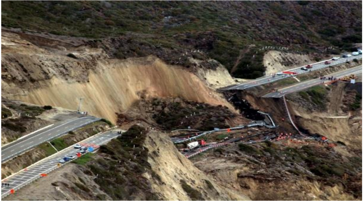
Fig. 1-2 Afectaciones a la Carretera Escénicas con el deslizamiento del 28 de diciembre de 2013 (Pedraza, 2013)
