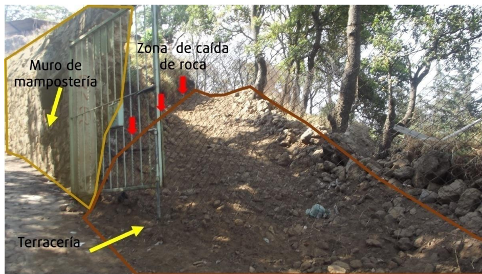
Fotografía 5. Obras de mitigación que consisten en un muro de mampostería de 40 cm, enmallado y una berma artesanal con el fin de evitar la caída de roca. (19.2142° N, 99.1000° W. Calle: Camino al Panteón).
