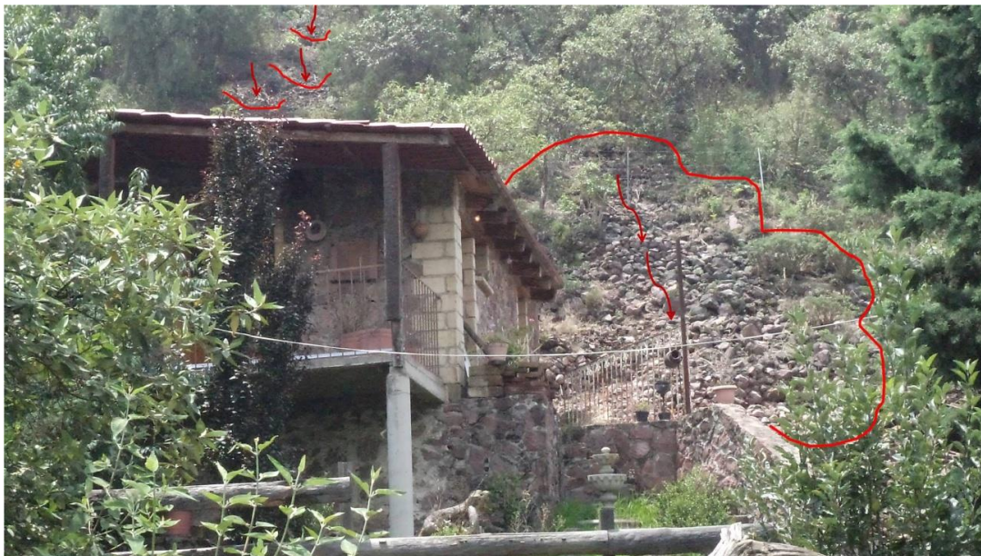
Fotografía 2. Vivienda expuesta al peligro por caída de rocas. (19.2301° N, 99.1271° W. Calle: Cerro Tetequilo).
