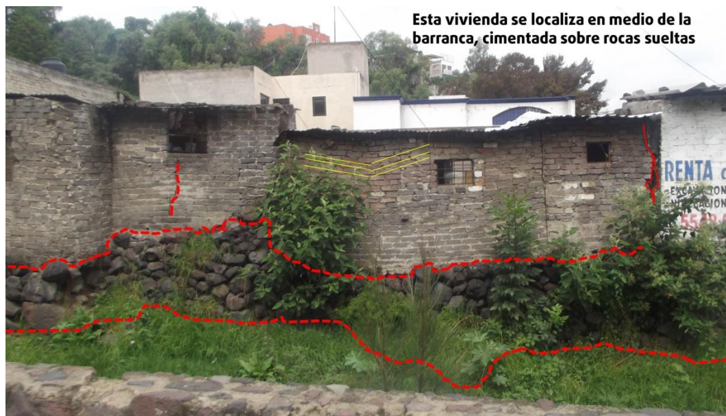
Fotografía 7. Vivienda ubicada en Camino Antiguo al Río San Lucas.
