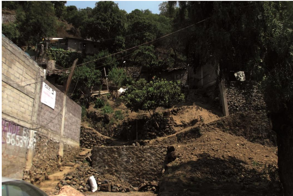
Fotografía 15. Construcciones vulnerables ante un derrumbe en el Cerro Tezontitla a pesar de contar con obras de mitigación. (19.2250° N, 99.0947° W. Calle: Camino Real a San Bartolo).
