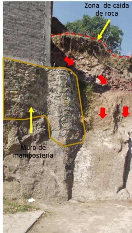
Fotografía 6. Obra de mitigación precaria. (19.2140° N, 99.0999° W. Calle: Camino al Cerro Tepetonco).
