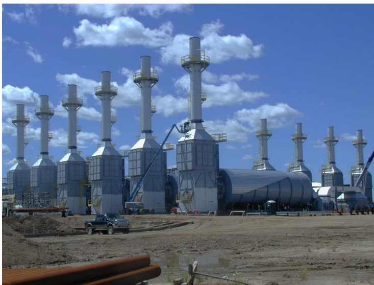
Ilustración 12-Generadores de vapor (Tomada de http://www.tiwwestern.com/once-through-steam-generators/image?view=image&format=raw&type=orig&id=35 )
