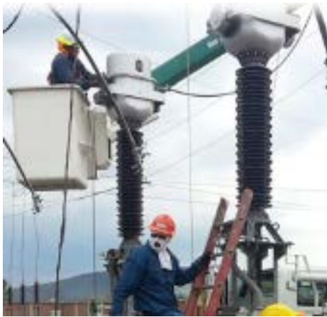
Figura 2.23 Transformadores de corriente subestación de distribución
