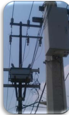
Figura 1.5 Transformadores de baja tensión
