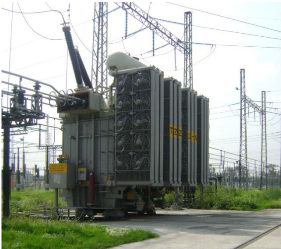
Figura 3.1 Transformadores de subestación de distribución
