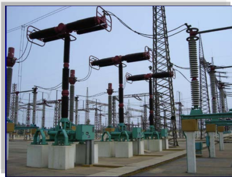
Figura 2.17 Interruptor de potencia en subestación de distribución
