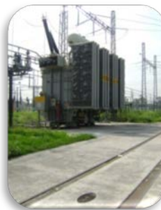
Figura 1.3 Transformadores de distribución
