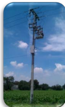
Figura 1.4 Líneas de media tensión
