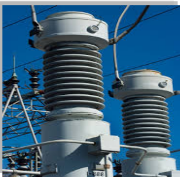
Figura 2.18 Transformadores de corriente subestación de distribución
