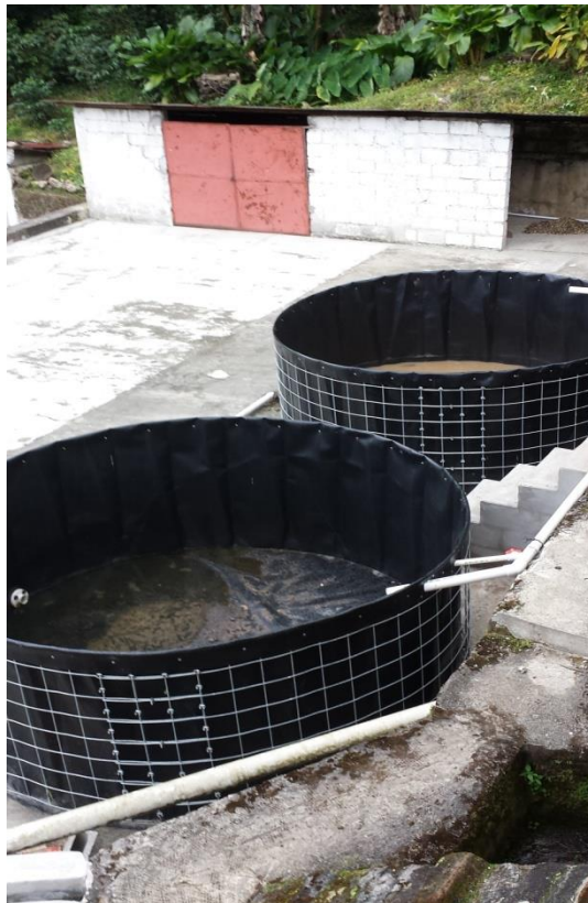
Figura 6.10 Tanques de tratamiento secundario
