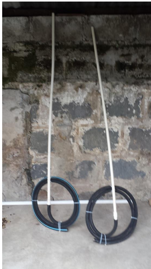
Figura 6.9 Manguera difusora para mezcla del coagulante en el agua.
