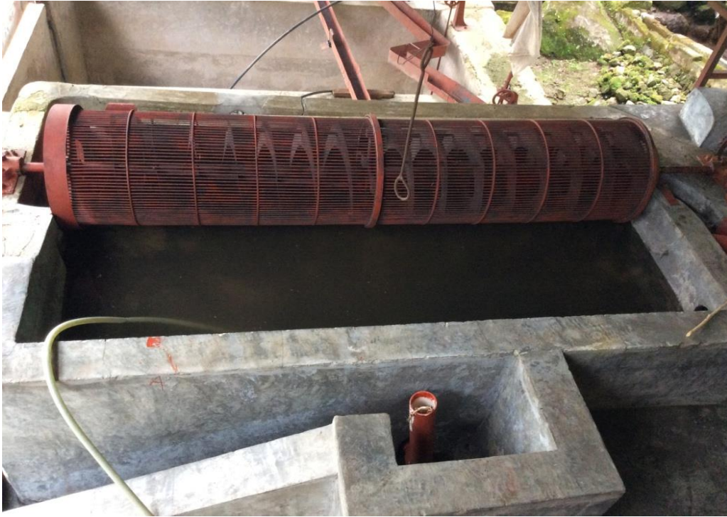
Figura 3.7 Tanque separador de criba horizontal con tornillo “sin-fín”
