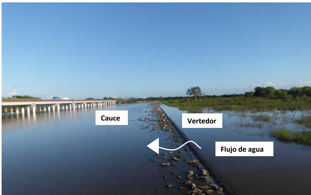
FIGURA 3.1.1.7 VISTA DEL VERTEDOR EN OPERACIÓN
