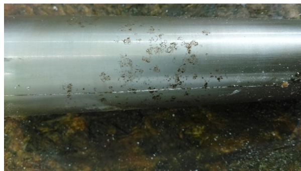
Ilustración 28 fisura en boquilla
