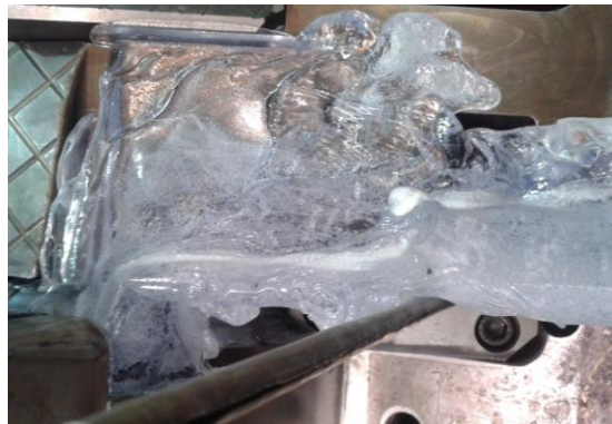
Ilustración 26 material atascado detrás de los módulos de las cavidades
