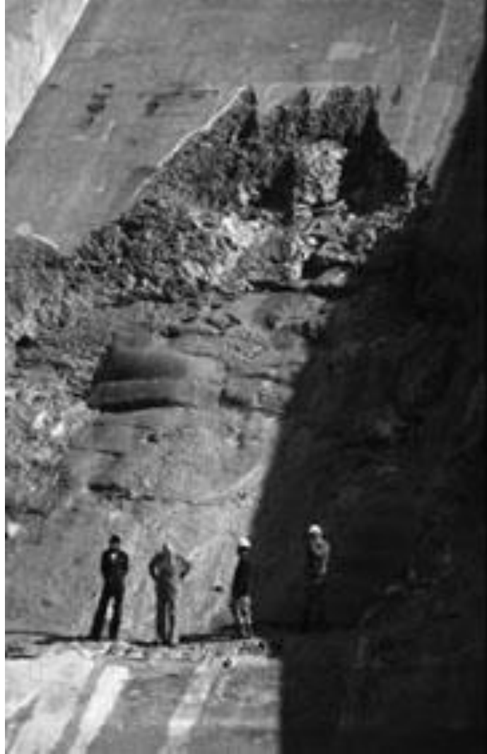
Figura 2.9 Daños por cavitación en la Presa Karun, Irán
