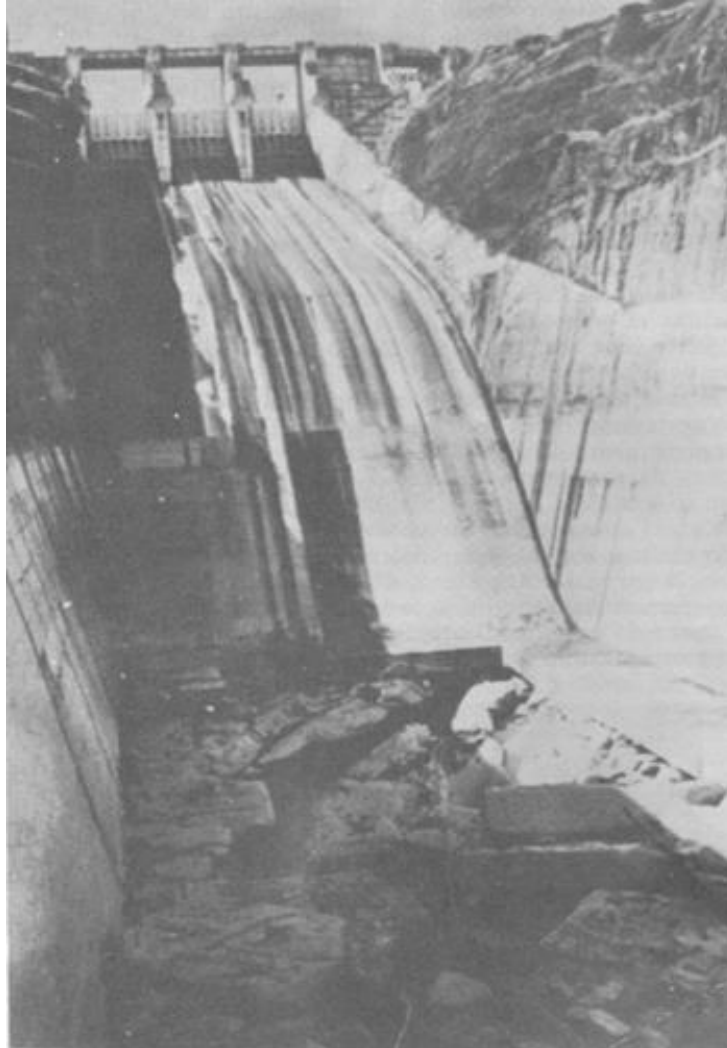
Figura 3.1 Daños en las losas de fondo del tanque amortiguador del vertedor de servicio, octubre de 1970.
