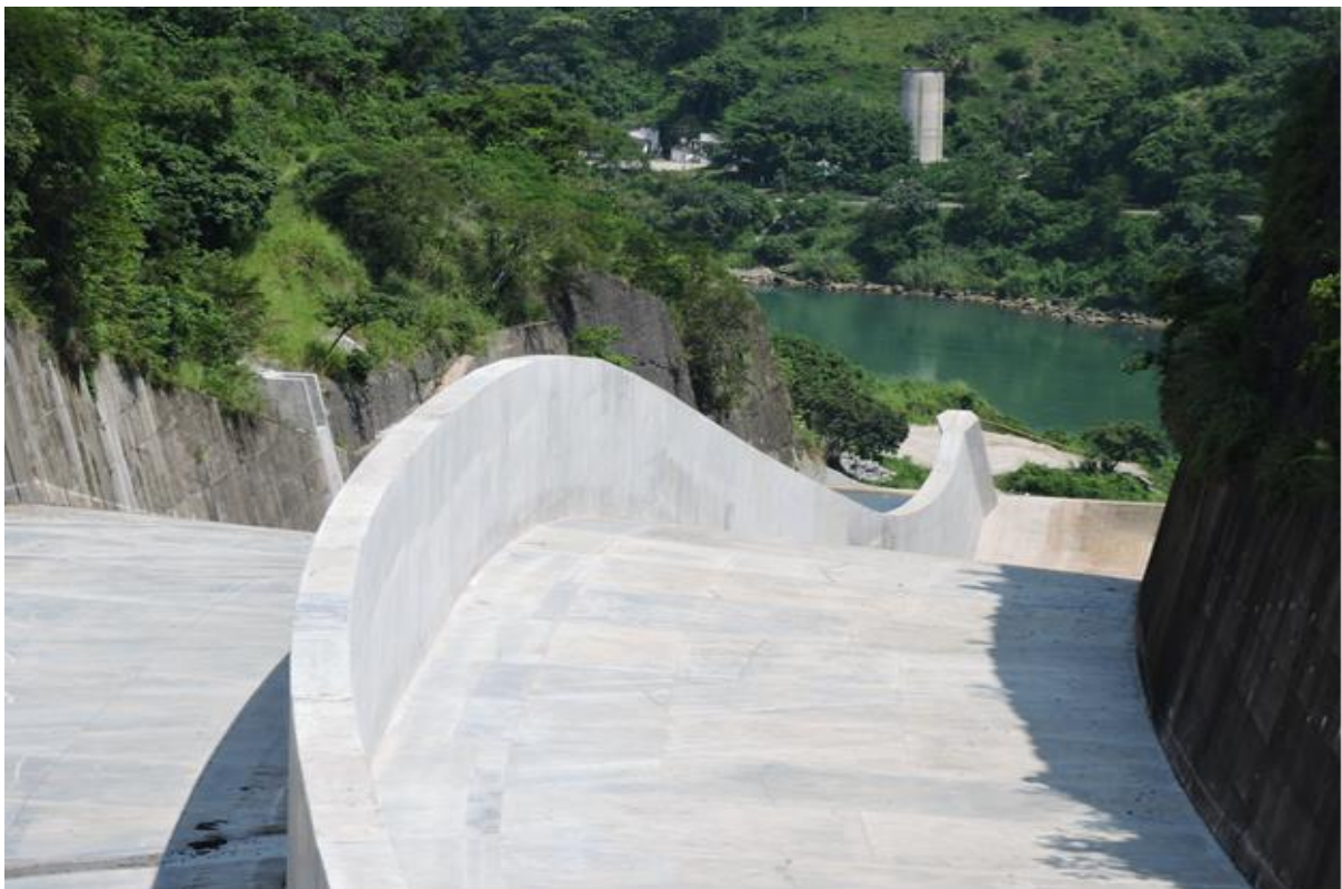
Figura 3.20 Sobreelevación en plantilla de ambos canales
