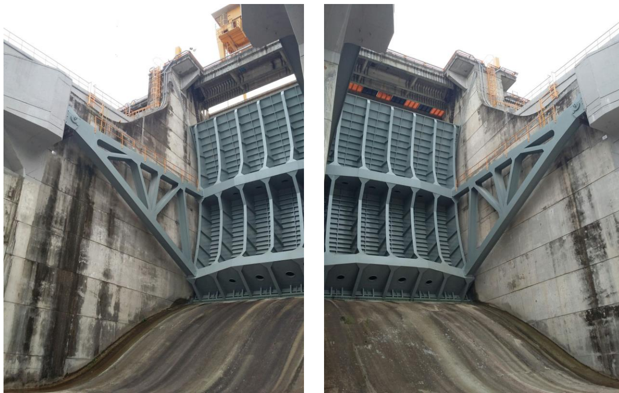
Figura 3.24 Compuertas del vertedor de emergencia reforzadas
