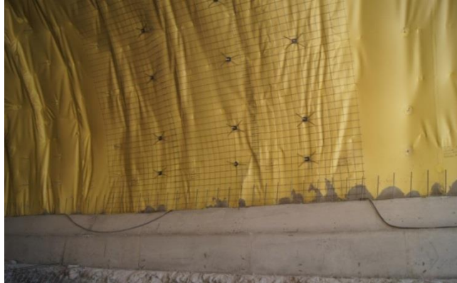
Figura 2. 6. Ejemplo de impermeabilización sobre un revestimiento de concreto lanzado. Túnel en la Carretera Toluca-Naucalpan, México (Cortesía Consultec).
