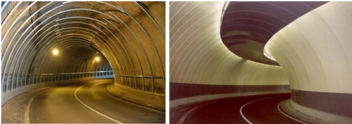
Figura 8.2. Colocación de panel en hastiales y clave de túnel. Tomada de Alliance, Ref. [26].
