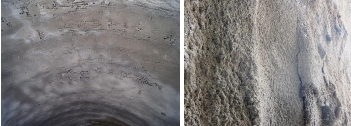
Figura 5.7. Defectos de aplicación concreto lanzado, Túnel Toluca-Naucaupan, México.
