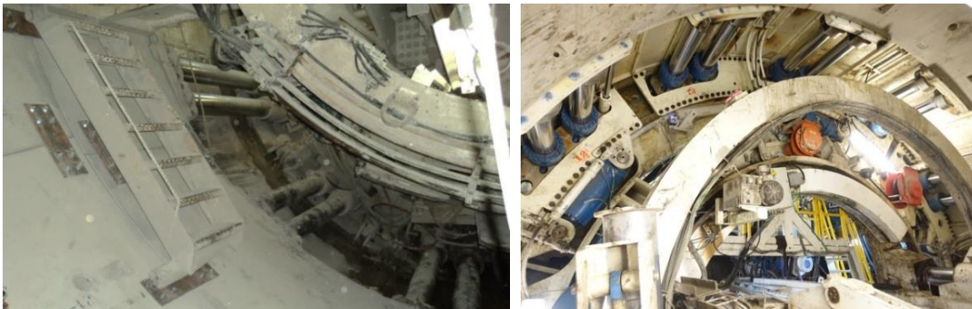
Figura 2.21. Apoyo de la tuneladora en las dovelas durante el proceso de excavación.
