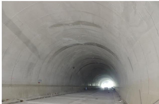
Figura 5.2. Presencia de zonas con humedad en revestimiento de concreto hidráulico.
