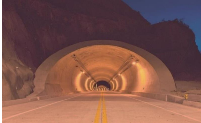
Figura 2.16. Revestimiento de concreto hidráulico en un túnel de la Carretera Durando-Mazatlán, México.
