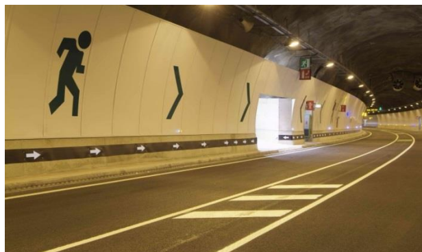
Figura 6.7. Marcas viales y señalización, Túnel Pont Pla, Andorra suroeste de Europa. Tomada de Alliance, Ref. [26].
