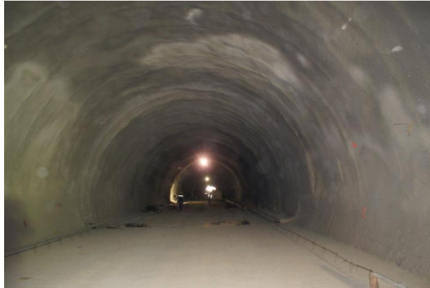
Figura 2.11. Revestimiento de concreto lanzado con malla electrosoldada. Túnel en la carretera Toluca-Naucalpan.
