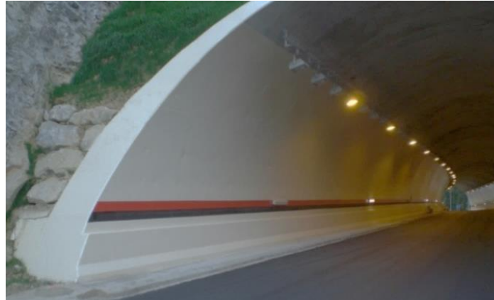
Figura 8.3. Pintura cerámica aplicada directamente sobre el concreto. Tomada de Alliance, Ref. [26].
