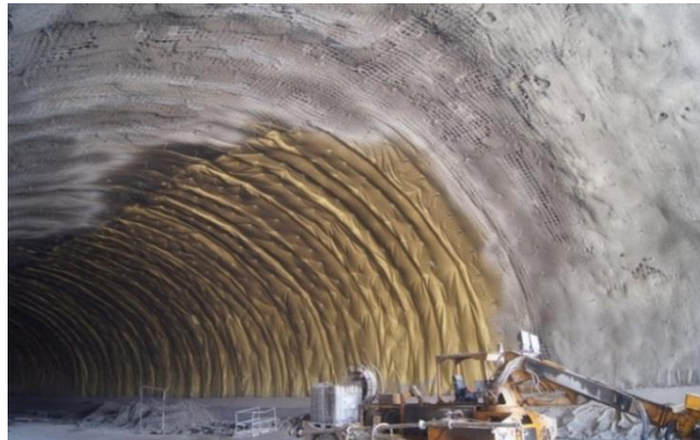
Figura 2.7. Revestimiento de concreto lanzado sobre la geomembrana y malla electrosoldada. Túnel Carretera Toluca-Naucalpan México (Cortesía Consultec).
