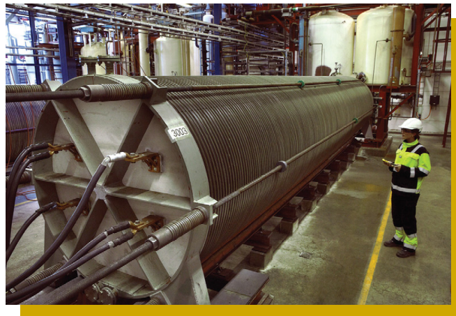
Figura 34. Electrolizador Alcalino de 2 MW.
