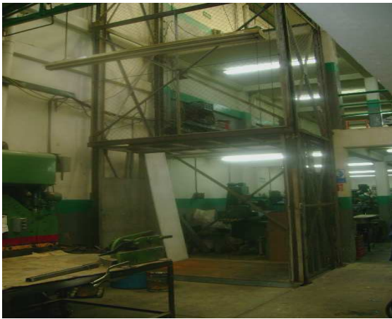
Figura 2.39. Elevador de carga. Caja de seguridad.
