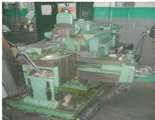
Figura 2.20. Cepillo a 220 V con conexión directa sin protección.
