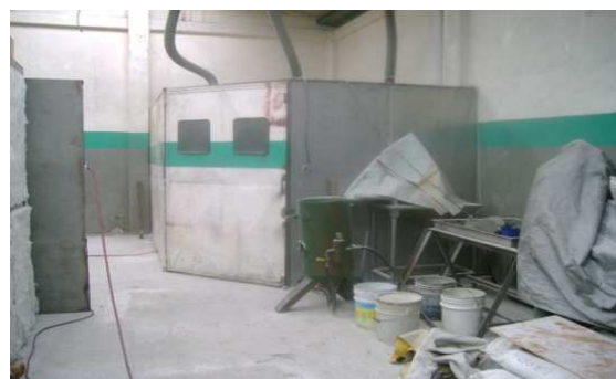
Figura 2.36. Cabina de acabado.
