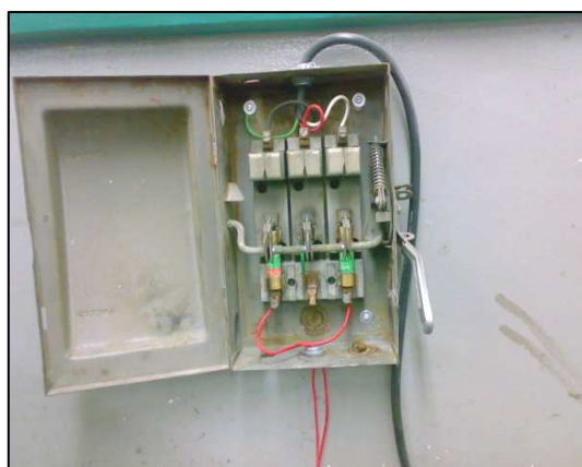
Figura 2.8B. Centro de carga abierto.
