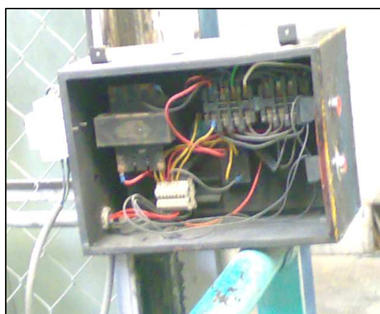
Figura 2.7 B. Cables expuestos.
