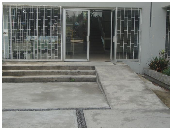
Figura IV.30. Entrada a DIMEI, obstrucción de rampa con puerta.
