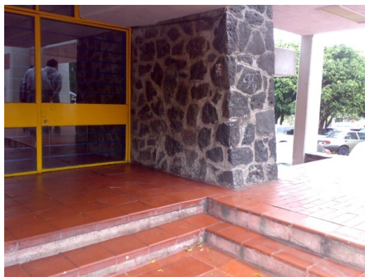
Figura V.3. Paso que se recomienda ampliar a 1.20 [m] de ancho
