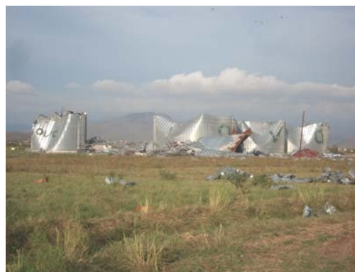
Figura 1.7. Silos dañados por vientos del huracán Lane en Sinaloa, 16 de septiembre de 2006 (UEPC - Sinaloa, 2006).
