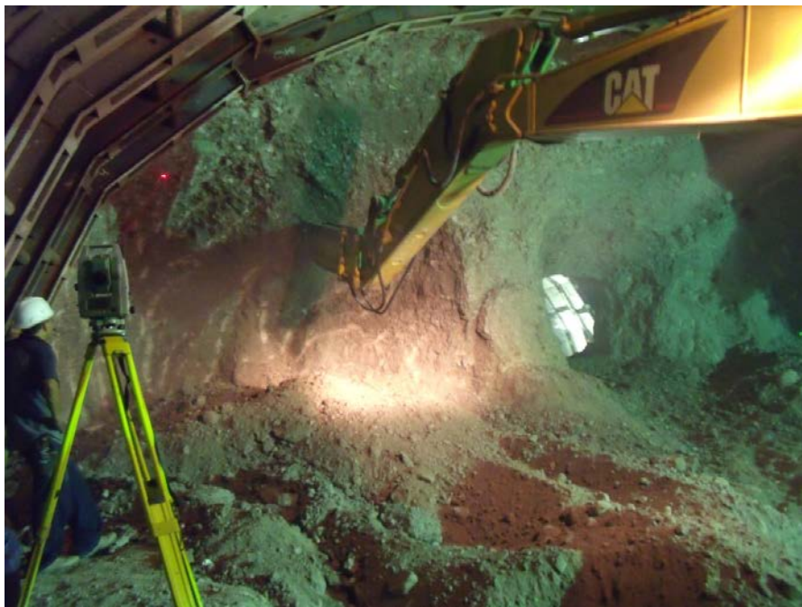
Fig. 4.1.4 Estación total a un lado del eje, indicando el límite de corte, con el rayo láser previo a una comunicación
