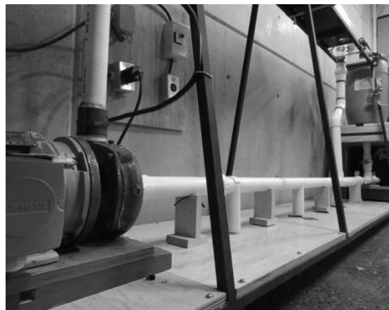
Fig. 18. Base de la estructura del Circuito Hidrodinámico
