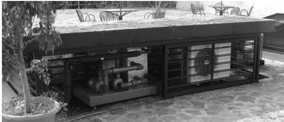
Fig. 14. Sistema de enfriamiento para el circuito hidrodinámico
