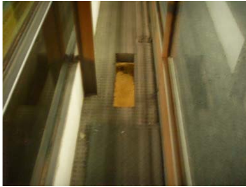
Imagen 23. Aberturas improvisadas en el corredor entre muros de las fachadas dobles.
