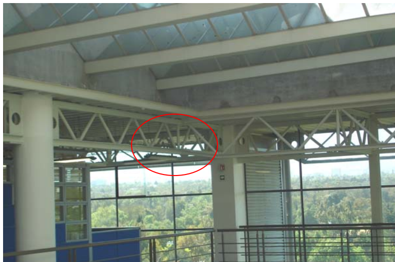
Imagen 37. Ubicación del sensor de temperatura del techo del 6 piso.
