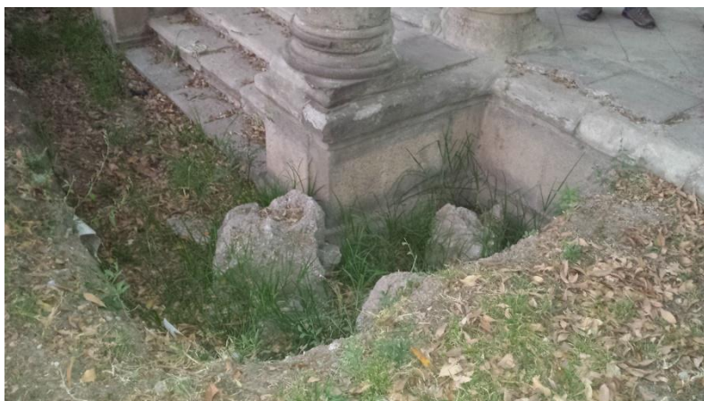
Figura 1. 18 Hundimiento del edificio (Puerta Principal San Jacinto)
