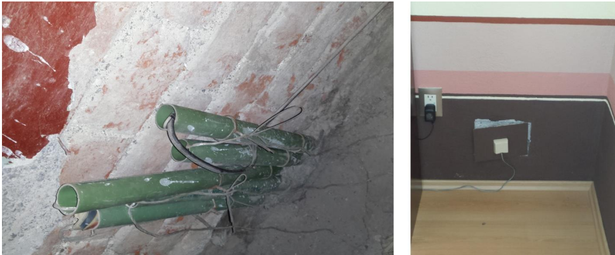
Figura 2. 3 A la izquierda se muestra la utilización de la canalización existente por parte de TELMEX y a la derecha se muestra el punto de salida del cableado de TELMEX dentro de la oficina
