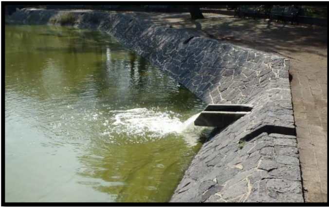
Gárgola tipo en operación
