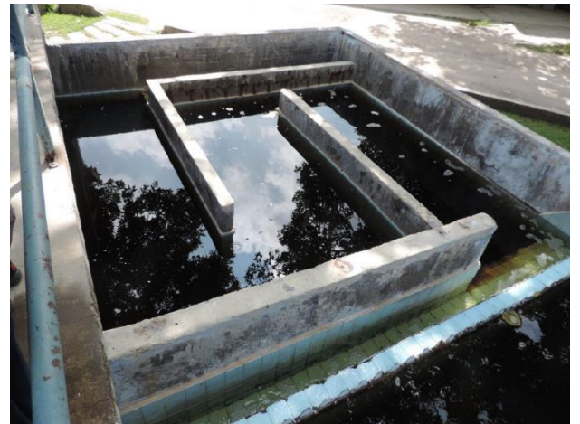
Fotografía 8. Tanque de contacto con cloro
