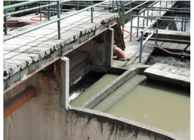
Fotografía 2. Vertedor sedimentador primario
