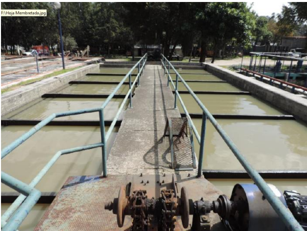
Fotografía 9. Tanque sedimentador primario
