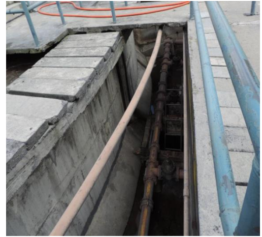
Fotografía 4. Tubería conducción de aire
