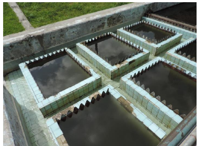
Fotografía 12. Tanques de contacto de cloro
