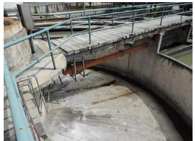
Fotografía 6. Grietas en digestor
