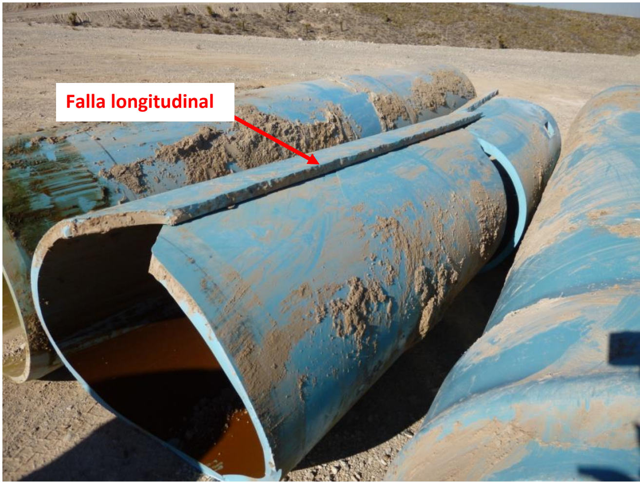
Figura 5.25. Fractura rápida en forma longitudinal en un tubo del acueducto Conejos-Médanos, producida cuando había no aire atrapado
