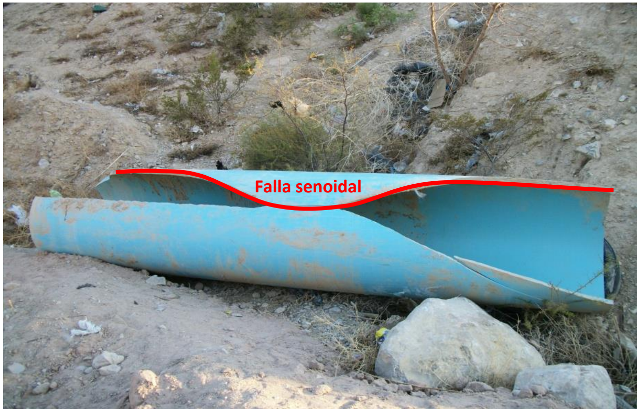
Figura 5.24. Fractura rápida de forma senoidal en un tubo del acueducto Conejos-Médanos, producida cuando había aire atrapado
