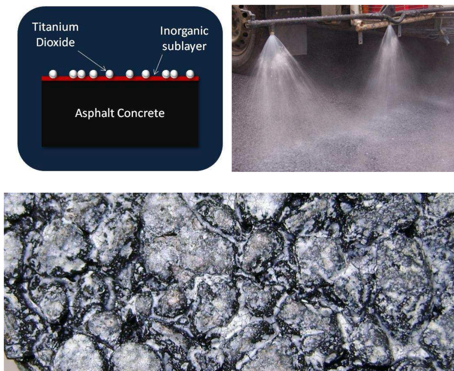
Figura 5.8 - Descripción y ejecución de técnica de pulverización sobre rodadura existente y estado final de la misma después de la aplicación.
