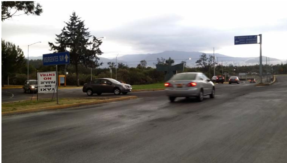
Imagen 22. Señalización en mala posición. Circuito Mario de la Cueva
