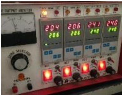
Figura 30 Controlador de resistencias del sistema de canal caliente, de izquierda a derecha, zona 1 controla la resistencia del bebedero, zona 2 controla la resistencia del distribuidor de plástico, zona 3 controla inyector 1, y zona 4 inyector 2
