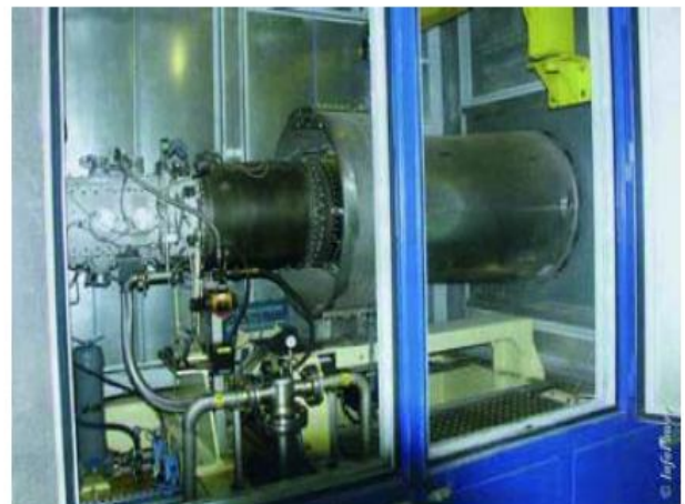
Figura 16: Turbina de gas 3.8 MW. Papelera del Oria.
