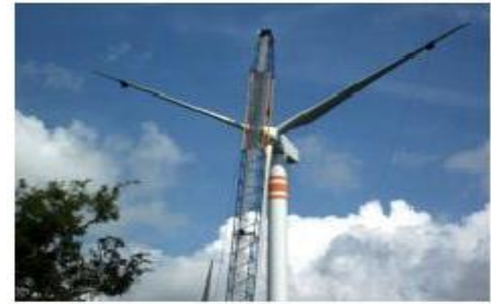
Figura 79. La Central La Venta III.
