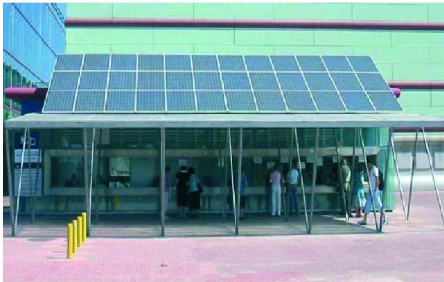
Figura 30. Instalación de energía fotovoltaica en IFEMA (Madrid).
