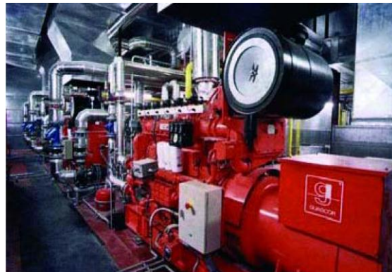
Figura 12: Equipos de generación de la Universidad de Santiago Compostela.
