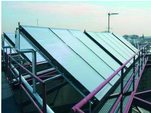
Figura 26: Solar térmica en el hotel Husa Princesa (Madrid).
