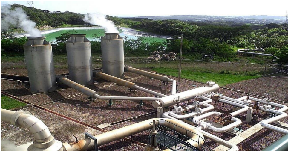
Figura 14.- Planta geotérmica las Pailas.
