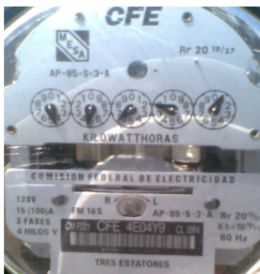
Fig. 8. Medidor trifásico. Fuente: foto tomada en campo.
