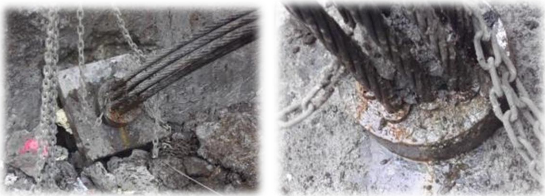
Figuras 86. Corrosión en ancla temporal.
