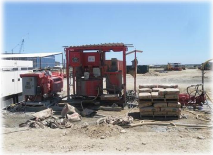
Figura 62. Central de lechada mezclador AC-83.
