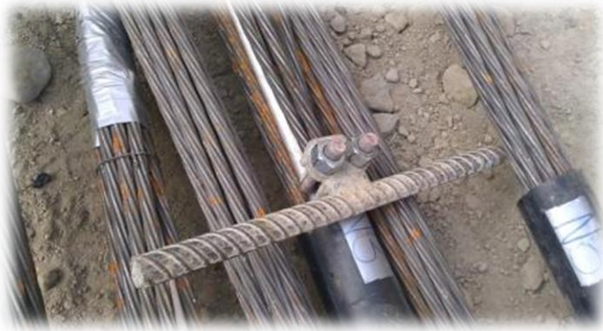
Figura 43. Instalación de retenedores metálicos previo a la colocación del tirante dentro del barreno con el fin de sostener el tirante una vez dentro del barreno.
