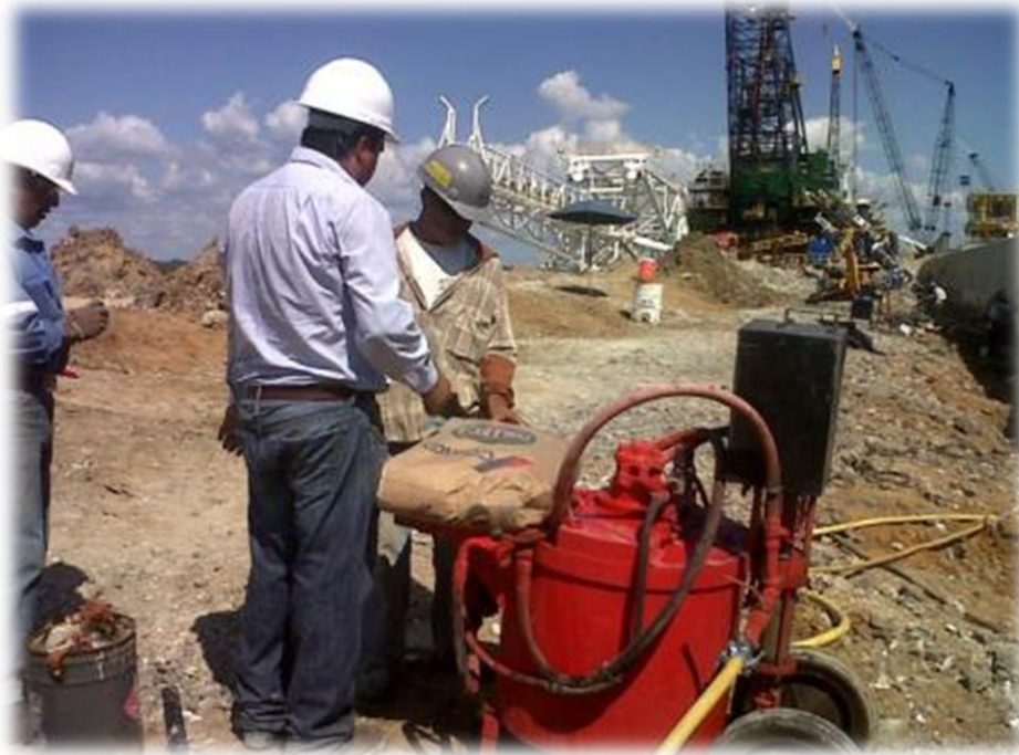
Figura 82. Se fabrica la lechada para la parte libre del ancla para los trabajos de protección en anclas permanentes.
