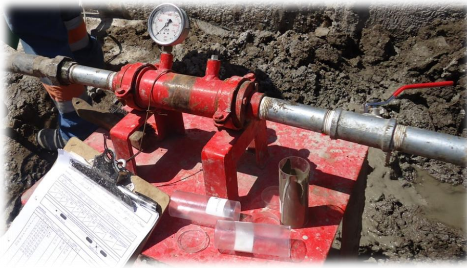
Figura 63. Banco con manómetro para tomar la presión de inyección.
