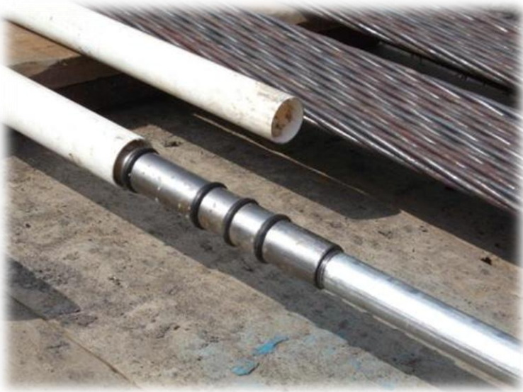
Figura 64. Tubería y obturador (ancla temporal).
