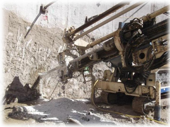
Figura 55. Maquinaria perforadora SOILMEC SM-18 realizando trabajos de perforación en un muro Milán.
