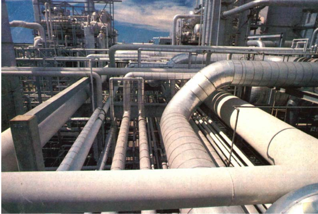
F.I.2 Vista interior de un "rack" de tubería
