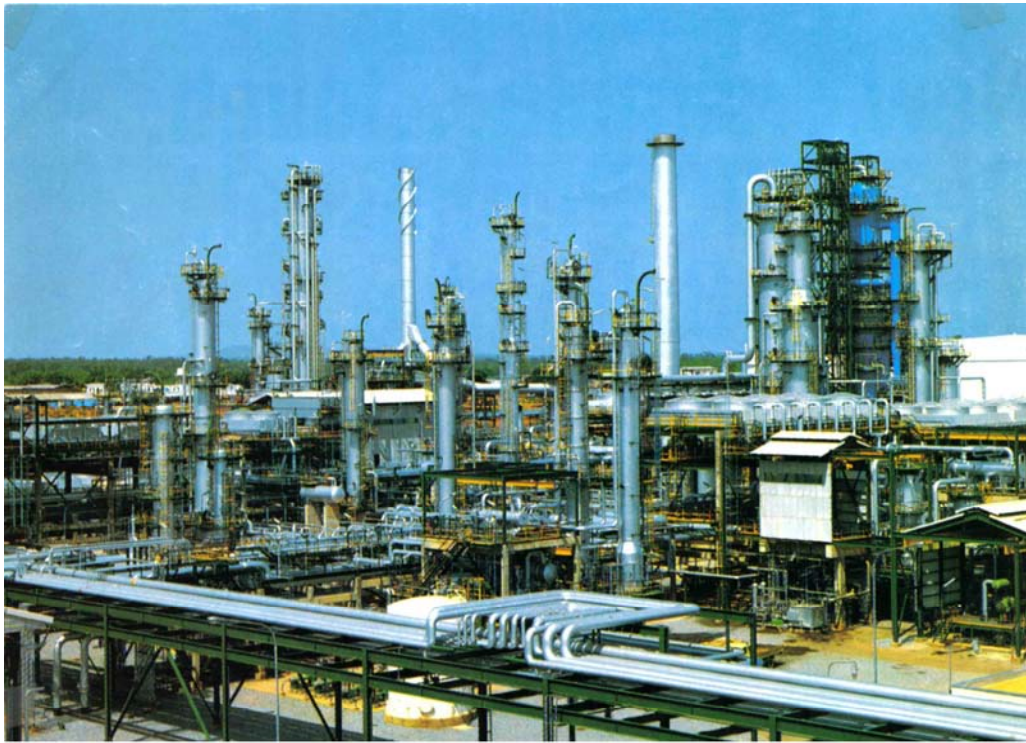
F.I.5 "Loops" de tubería (abajo al frente) en una planta
