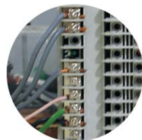
Foto 5. Conexiones del termostato.
