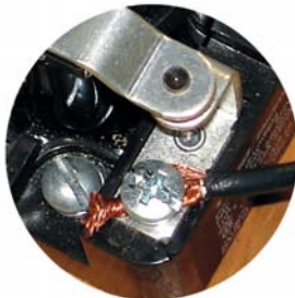
Foto 3. Conexión del contactor.
