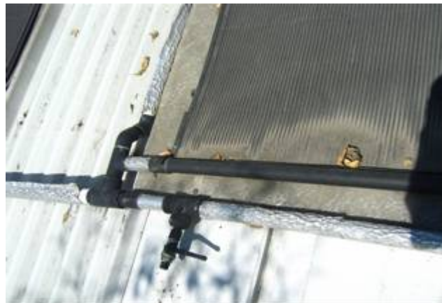
Fotografía 5 Pequeña fuga de agua debido a sobre presión en el sistema.
