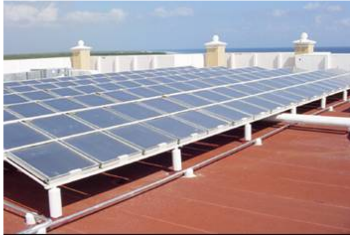
Fotografía 6 Campo de colectores aletados de cobre con cubierta de vidrio
