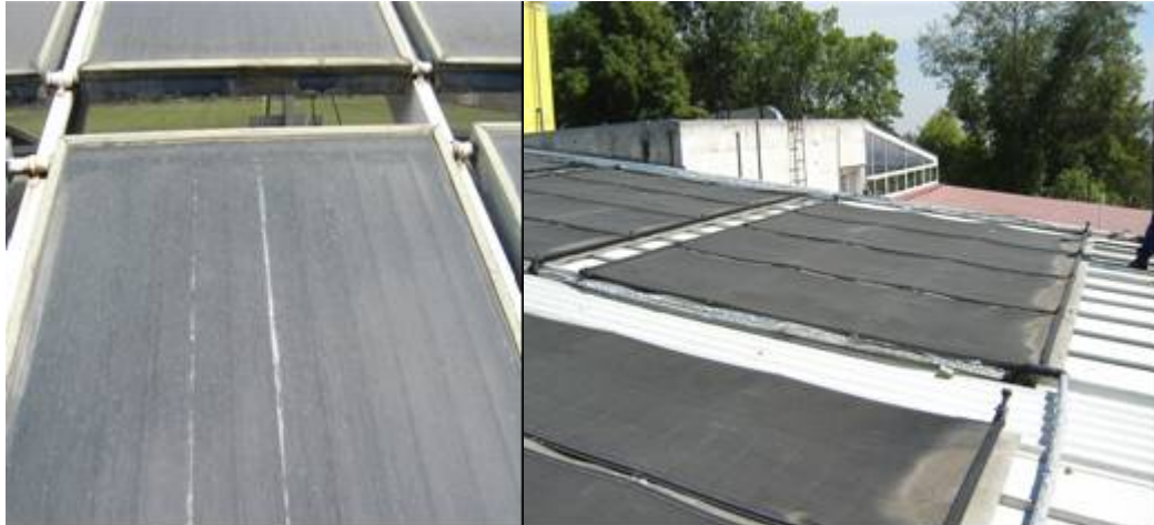
Fotografía 4 Deficiencias de mantenimiento
