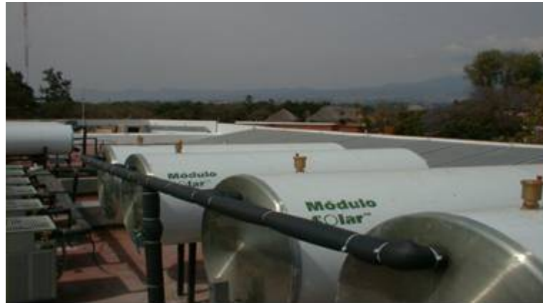
Fotografía 3 Termo tanques instalados para almacenar el agua caliente.
