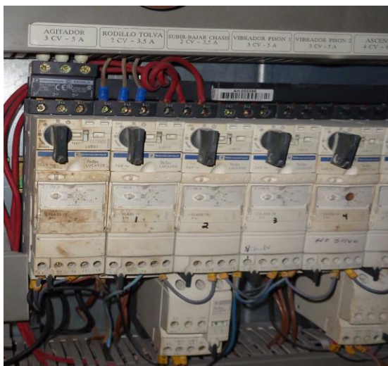
Figura 25. Contactores con térmicos.
