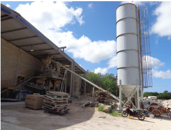
Figura 19. Silo de cemento y tornillo sin fin que alimenta a la mezcladora.
