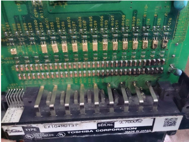
Figura 16. Tarjeta de PLC carbonizada.
