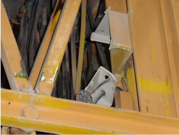
Figura 7. Caja de conexiones destrozada.
