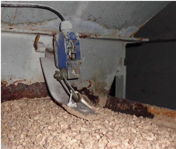
Figura 8. Microswitch con la palanca dañada y con una solución temporal.
