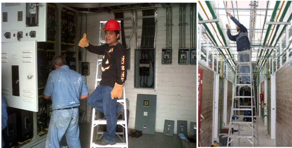
Figura 3-1 Levantamiento eléctrico en las instalaciones
