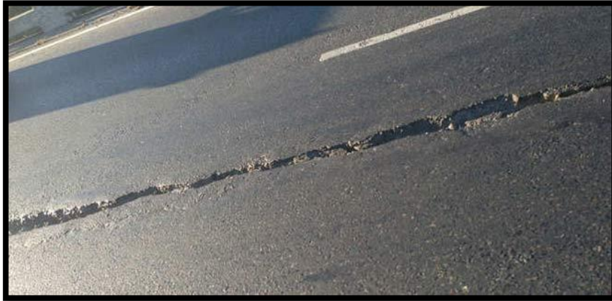
Figura 2.7 Fractura en pavimento asfáltico [48].
