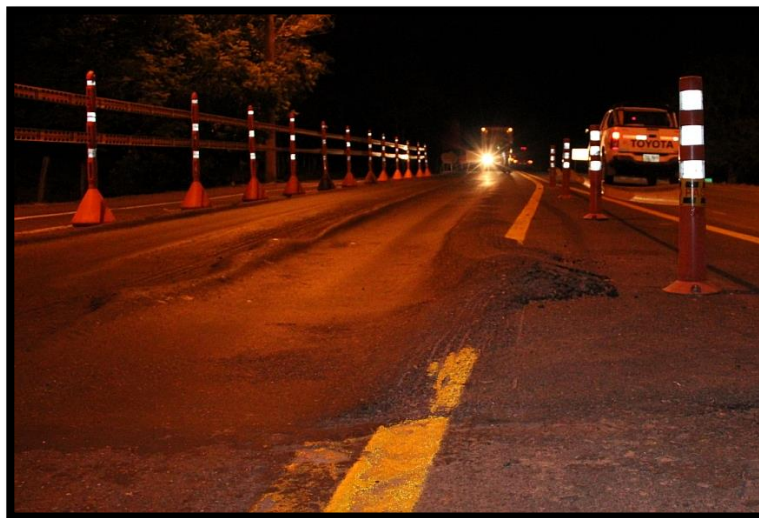
Figura 3.14 Ahuellamiento en carpeta asfáltica [48]
