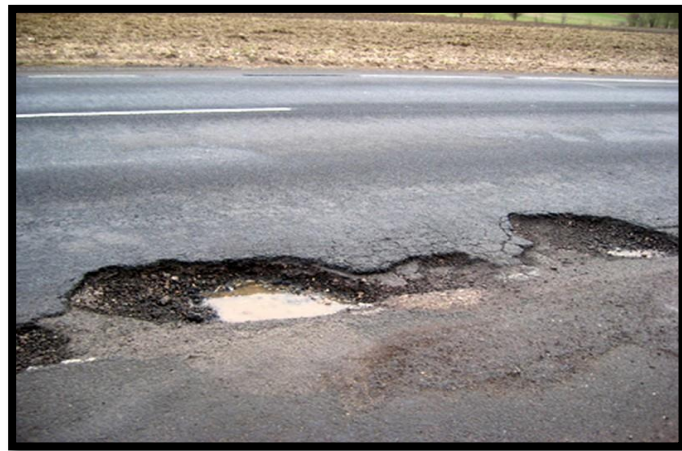
Figura 1.2. Bache en carpeta asfáltica [48].
