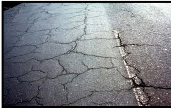
Figura 1.1 Agrietamiento en carpeta asfáltica [48].
