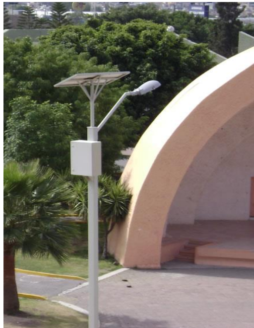
Figura 2.2.1 Luminaria solar autónoma de un panel solar fotovoltaico (Solarlux, 2012)
