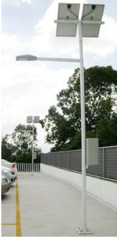
Figura 2.2.4 Sistema de alumbrado público con paneles solares. (Solarlux, 2012)
