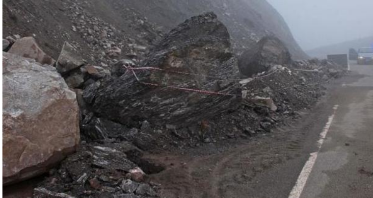
Figura 2.3.5: Falla por erosión en el Camino el Cuadrado, carretera en Argentina.
